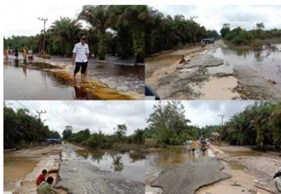
Gambar 2: infrastruktur jalan Desa Buluhcina rusak pasca banjir
